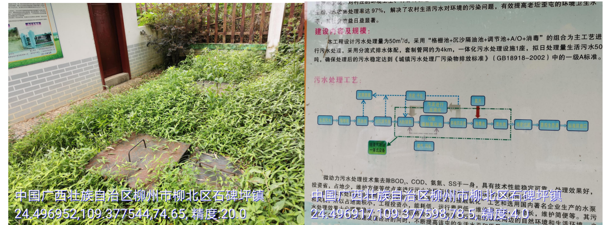
图 3.4-6 石碑坪镇下陶村农村生活污水处理设施
