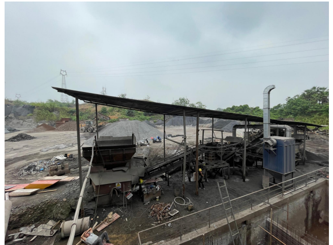
依托现有破碎区及 DA001 排气筒
